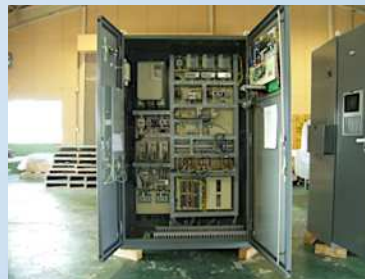
制御盤設計～組配
